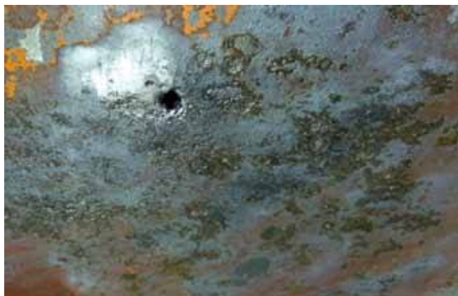
Door pitting of putcorrosie kan een metalen constructie onverwacht lokaal fors aangetast zijn. Dit brengt grote veiligheidsrisico's met zich mee, denk bijvoorbeeld aan een gat in de wand van een ballasttank. (foto http://wadder.ning.com )
